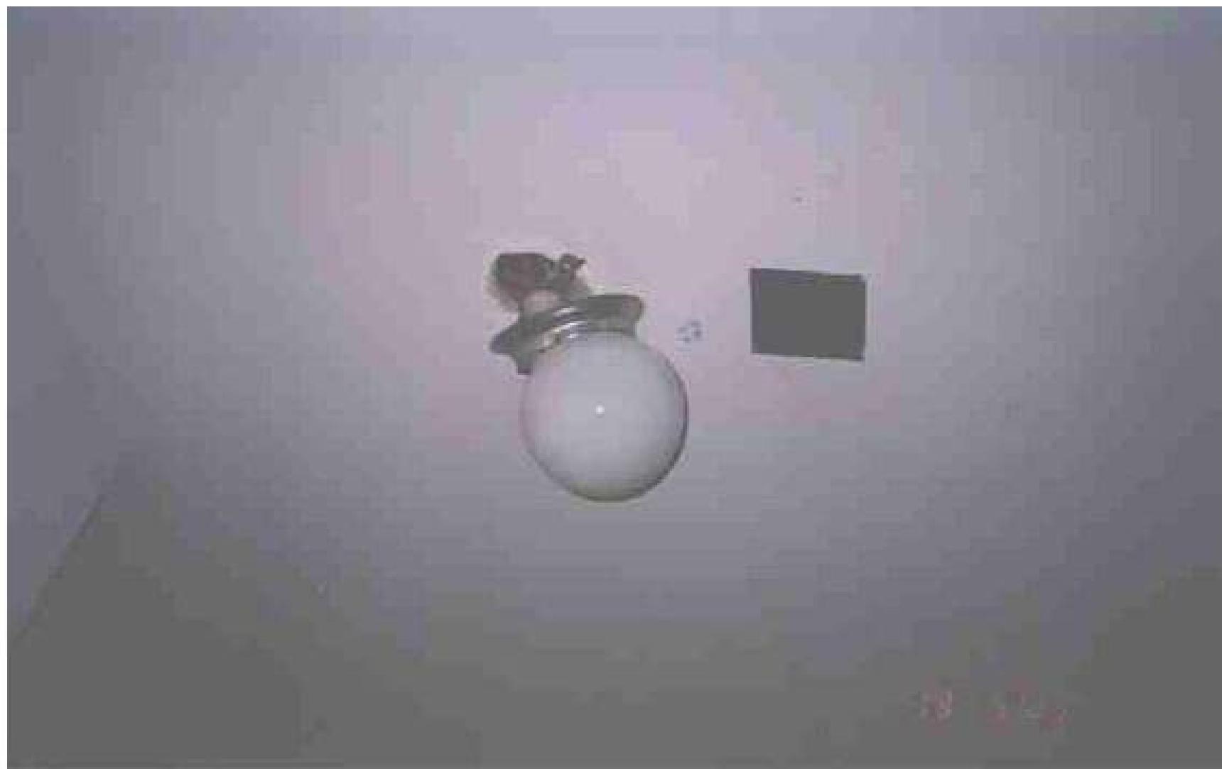
Foto 9 – Vista de luminária de emergência quebrada.
