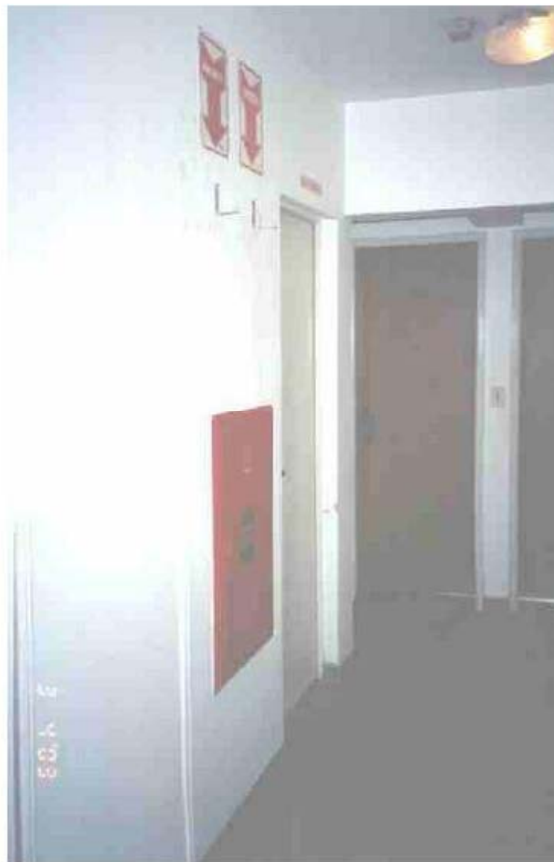
Foto 2 – Vista do local dos extintores no andar tipo de um dos edifícios, no detalhe a falta dos dois extintores.
