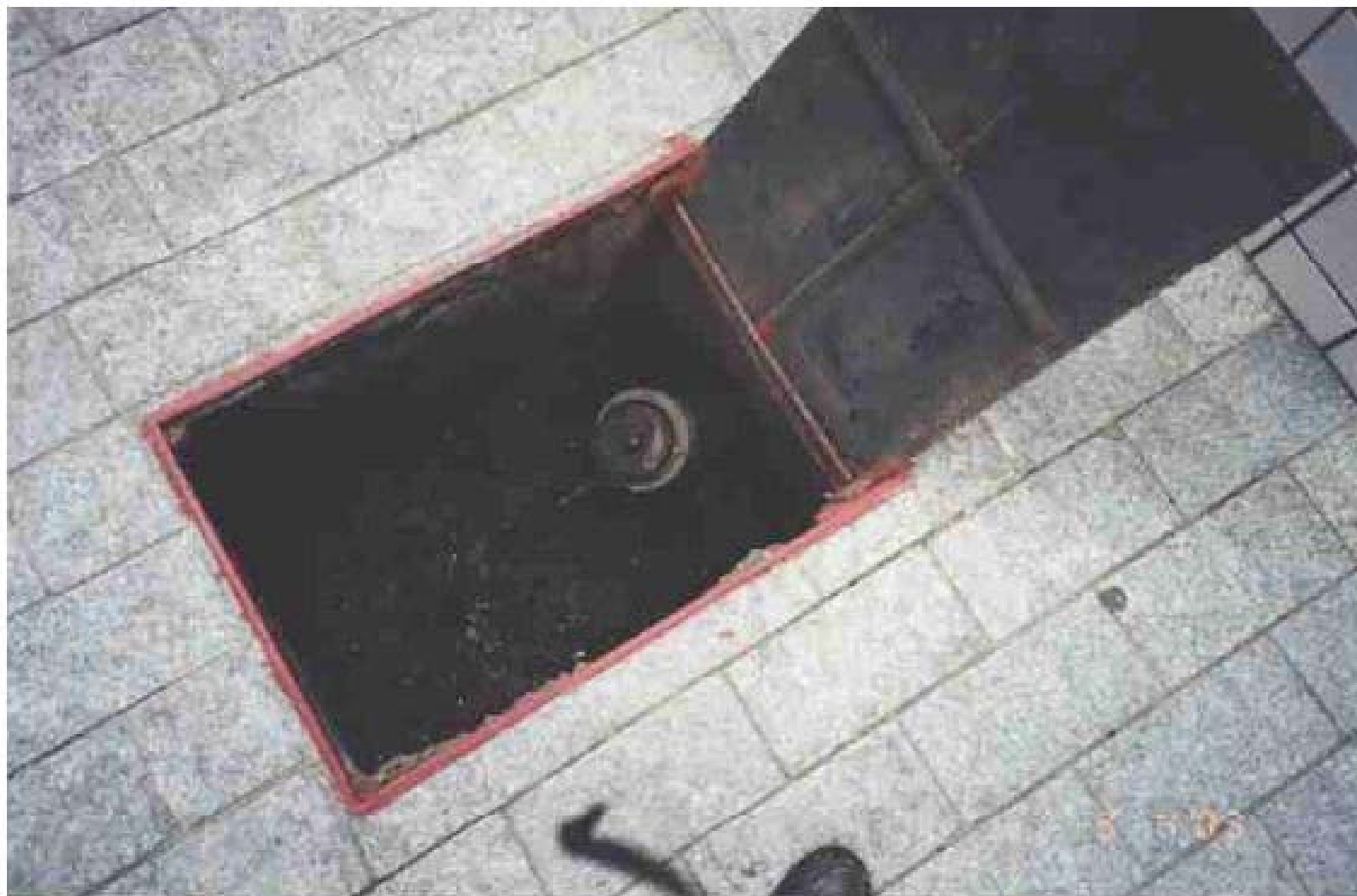
Foto 8 – Vista do RR (Registro de Recalque) de um dos edifícios, quebrado e sem sinalização.
