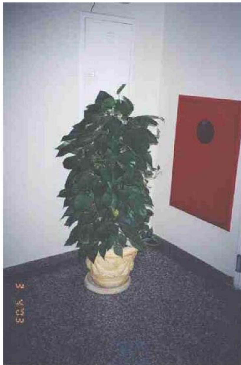
Foto 5 – Vista de vaso ornamental obstruindo a caixa de hidrantes do pavimento térreo de um dos edifícios.
