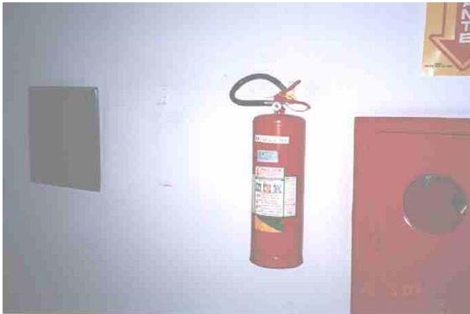
Foto 1 – Vista do local dos extintores no andar tipo de um dos edifícios, no detalhe a falta do extintor de pó químico B/C e caixa de hidrantes sem vidro protetor.
