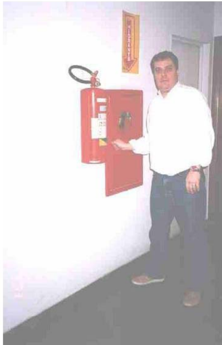
Foto 4 – Vista de um inspetor tentando abrir a porta de uma caixa de hidrantes emperrada pela pintura.
