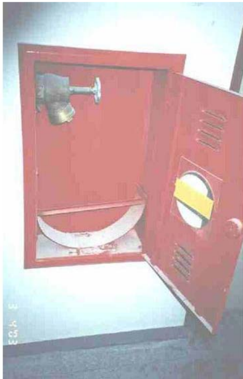
Foto 3 – Vista do local da caixa de hidrantes no andar tipo de um dos edifícios, no detalhe a falta da mangueira e chave de aperto.
