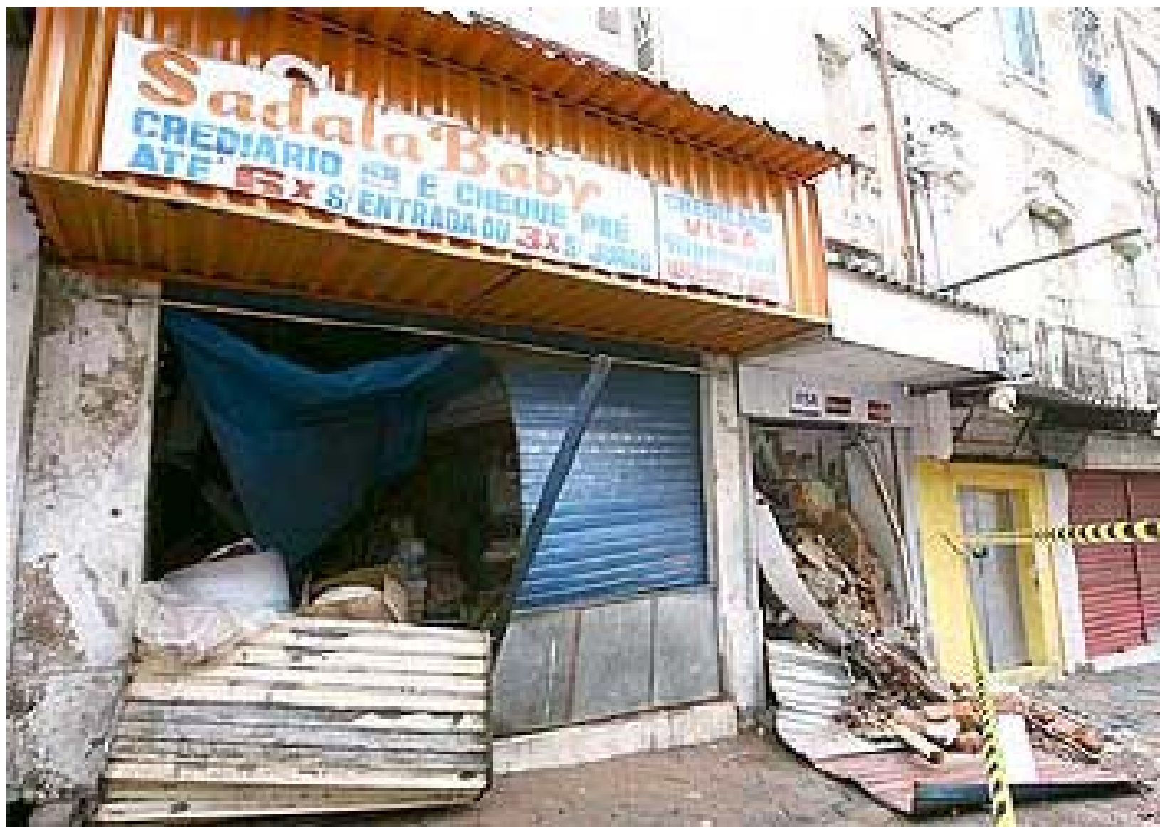
Colapso estrutural de Hotel - BA
