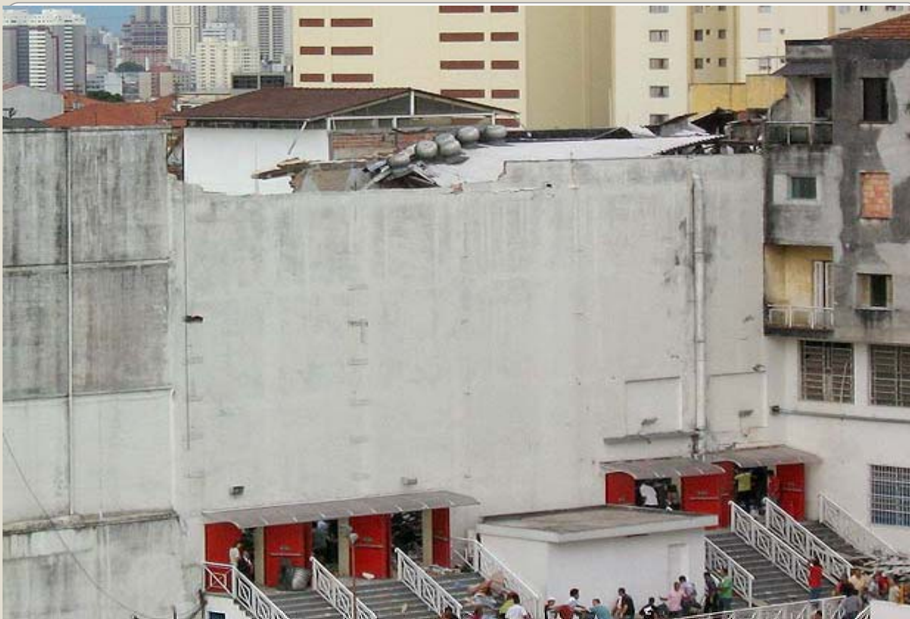
Colapso telhado - SP
