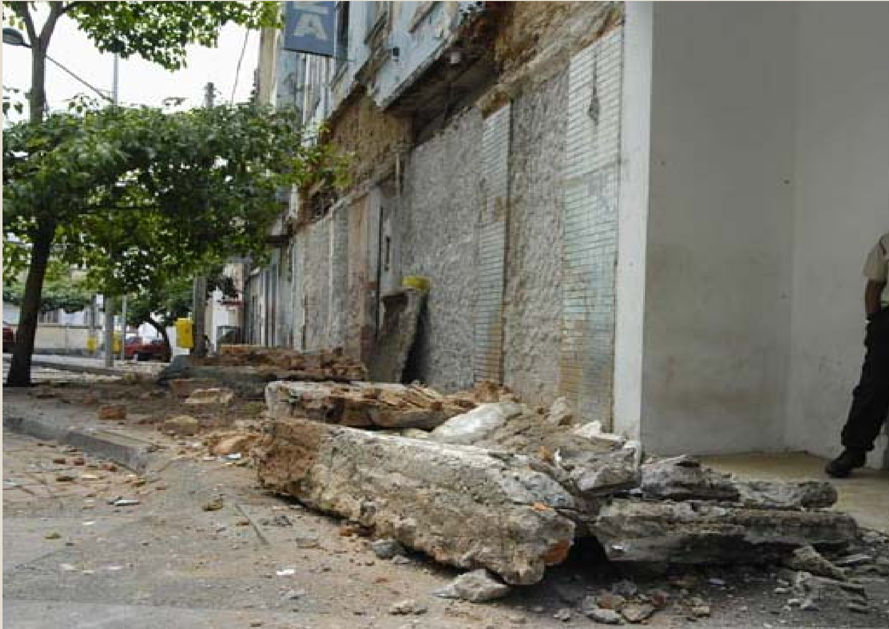
Colapso estrutural - Queda de marquise BA
