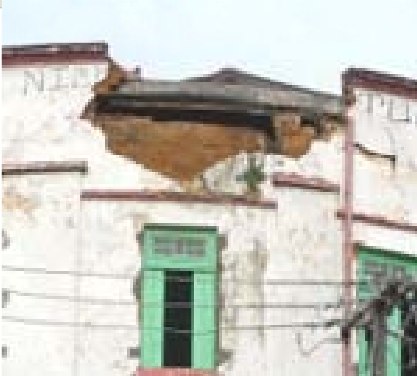
Colapso alvenaria de platibanda - MA
