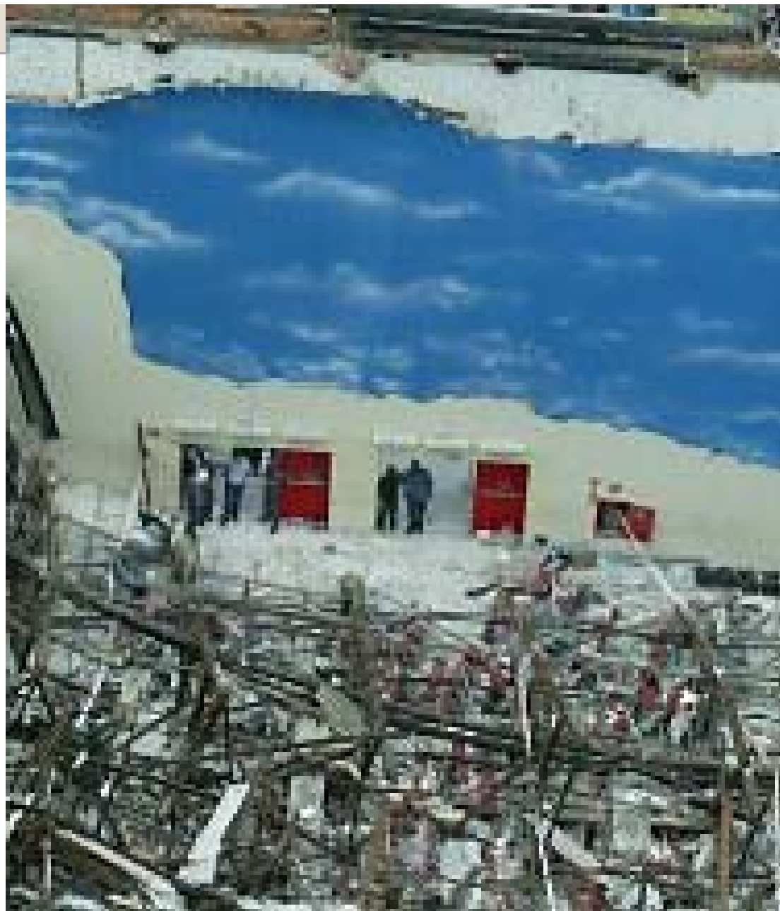
Colapso telhado - SP
